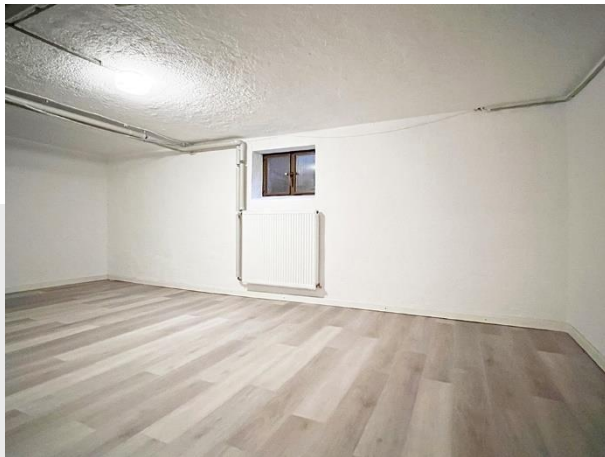
Raum mit Heizung
